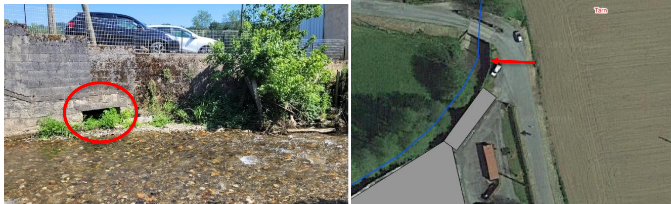
Illustration 4 : Ouvrage de décharge obstrué
