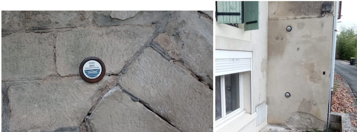
Figure 26 : Repères de crues du pont de Labruguière (à gauche) et du quartier du Thérone à Saix (à droite)
