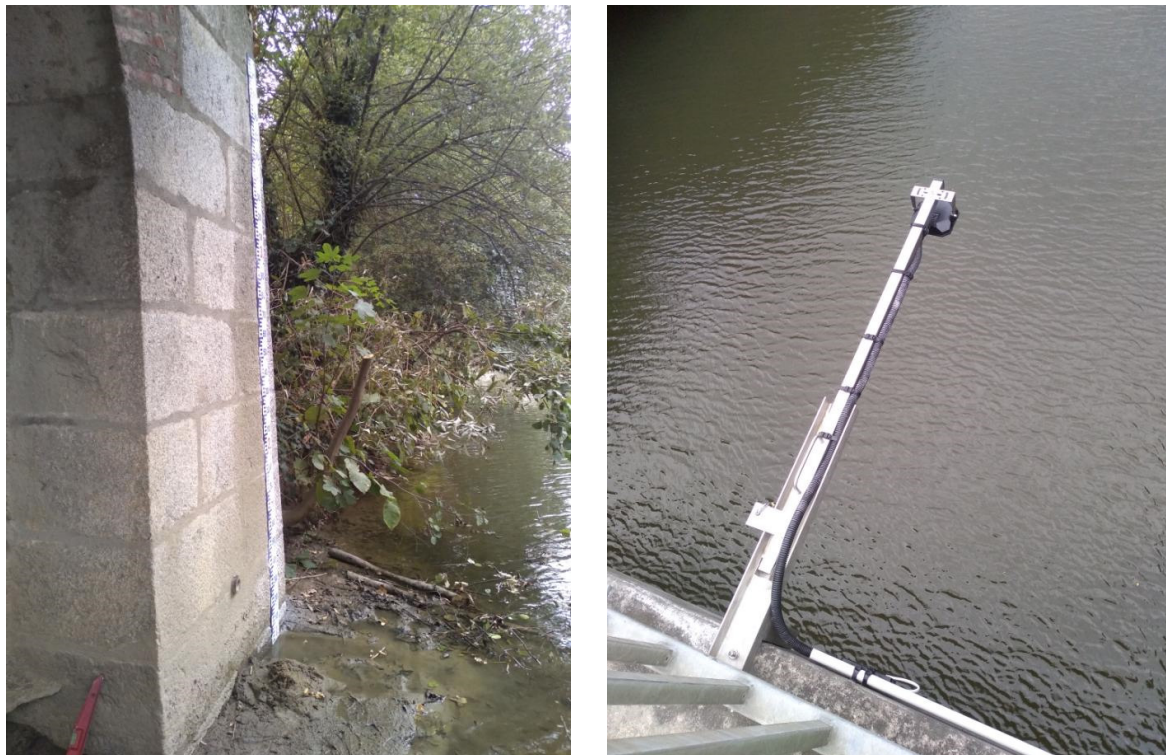
Figure 40 : Equipements de surveillance en place à Caucalières
