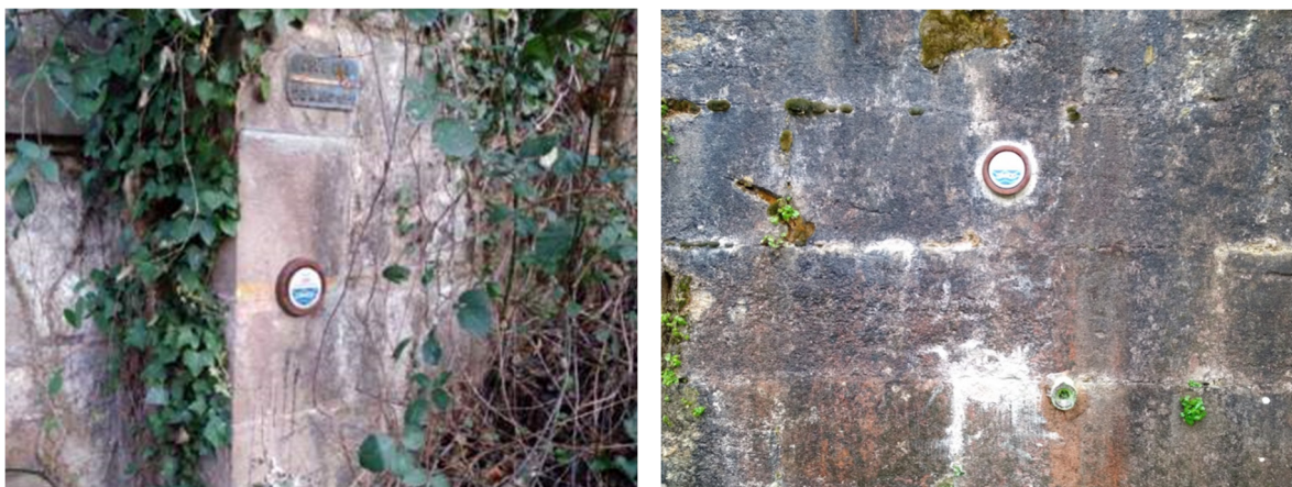
Figure 28 : Repères de crues du pont de la Carbonnière à Réalmont (à gauche) et au pont de la RD 612 à Saint-Genest-de-Contest (à droite)
