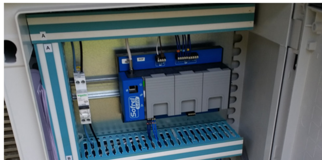
Figure 37 : Equipements de surveillance en place à Castaunouze
