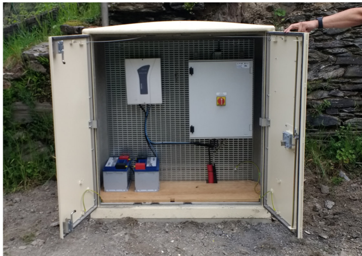
Figure 38 : Equipements de surveillance en place à Boissezon
