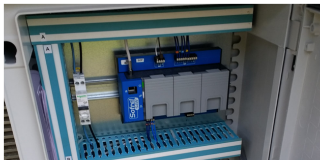
Equipements en place à Castanouze
