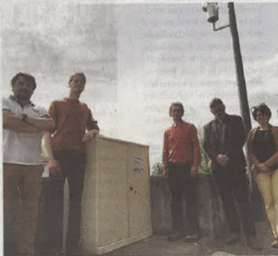
Une nouvelle station de surveillance des crues avec un radar, une échelle limnimétrique et un pluviomètre, a été installée le long de la Durenque, près de la salle Gérard Philippe. / DDM, P.B.
